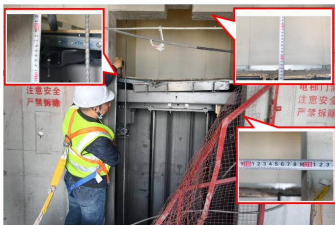
图 6 现场测得涉事电梯轿厢地面至卷绳器掉落所在楼层地面的高度约为 1.8 米，电梯轿厢地面至电梯井口顶部的高度约为 0.55 米，电梯轿厢与墙面的距离为 0.25 米。
