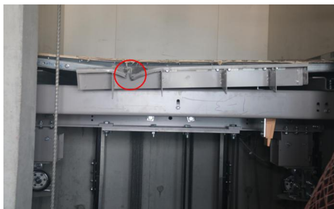
图 5 涉事电梯轿厢门坎已变形，轿厢地坎东侧出现破损
