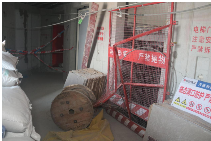
图 1 事故发生位置的电梯轿厢口
